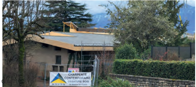
→ Le marché des travaux de charpente bois, de couverture et d'étanchéité de l'école maternelle du Haut-Meylan a permis l'emploi de personnes en voie de réinsertion. Les enfants retrouveront une école renouée en septembre.
